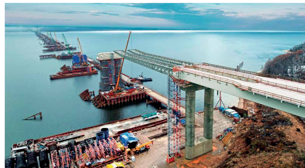
М-12 «Строящаяся скоростная автомобильная дорога Москва – Нижний Новгород – Казань», 8-й этап км 663 – км 729 с мостовым переходом через р. Волга, Республика Татарстан (от пересечения с автомобильной дорогой федерального значения Р-241 «Казань-Буинск-Ульяновск» до пересечения с автомобильной дорогой регионального значения «Сорочьи Горы – Шари»)
